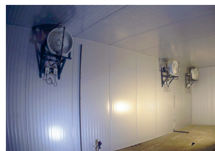
Циркуляционные вентиляторы секций с ТЭНами и форсунками-распылителями азота внутри камеры
