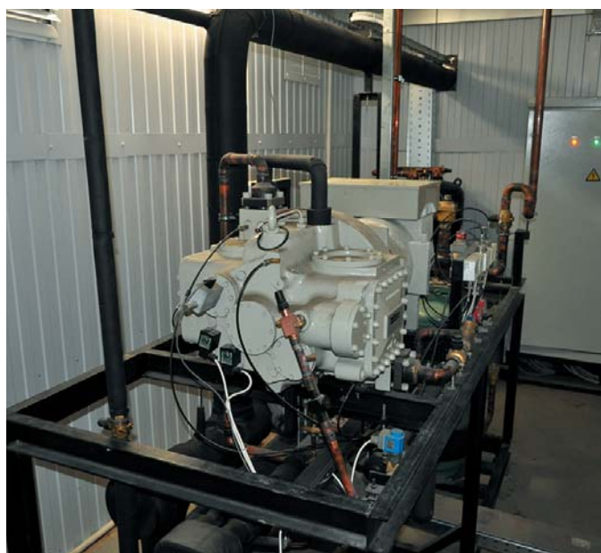
рис.7. Контейнерная компрессорная станция камеры глазировки креветок
