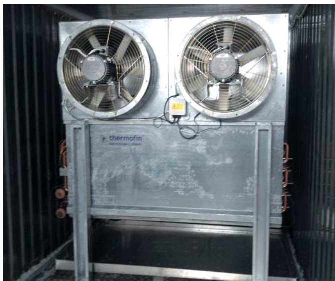
рис.6. Внешний вид испарителя шоковой заморозки (турбофриза), установленного в одной из контейнерных скороморозильных установок
